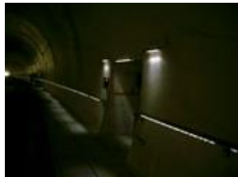
Handlauf mit integrierter Orientierungsbeleuchtung
