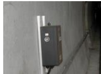
Einschalter für Beleuchtung
